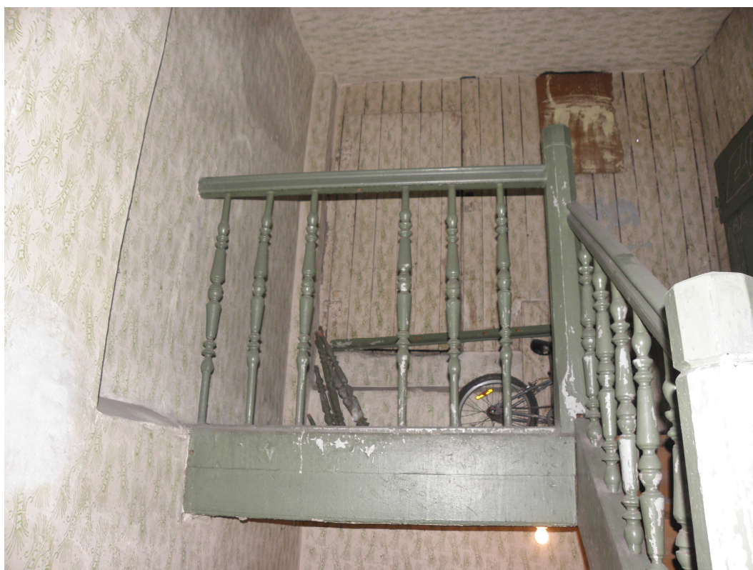
Fot- spocznik przed wejściem na strych
