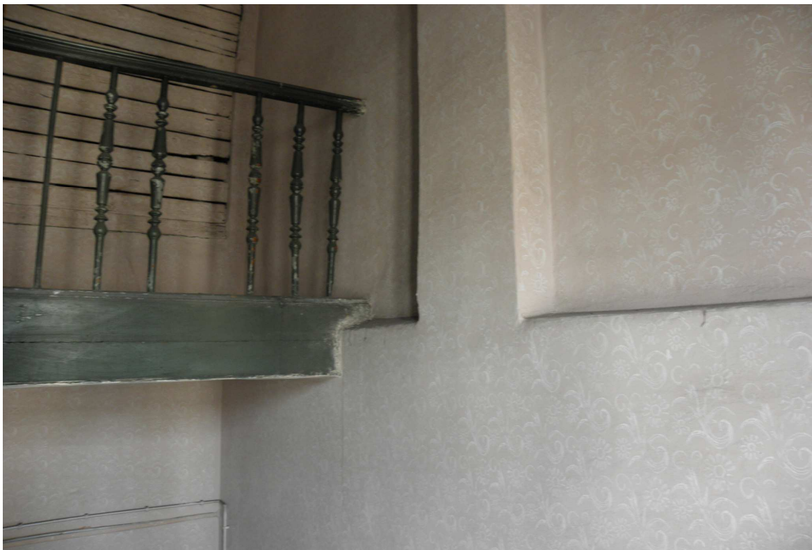
Fot- spocznik przed wejściem na strych
